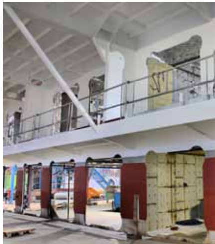
Die Passagierkabinen-Segmente werden mit allen Versorgungsleitungen bestückt. Die Kabinen sind so rasch angeschlossen.
